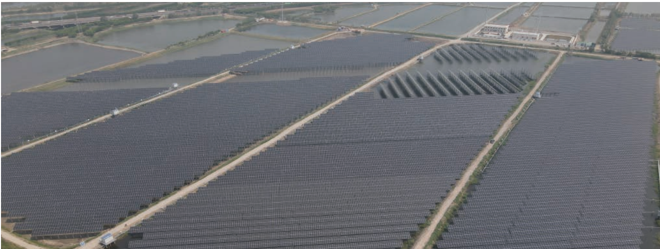
Tianjin, China Data de instalação: 2024
